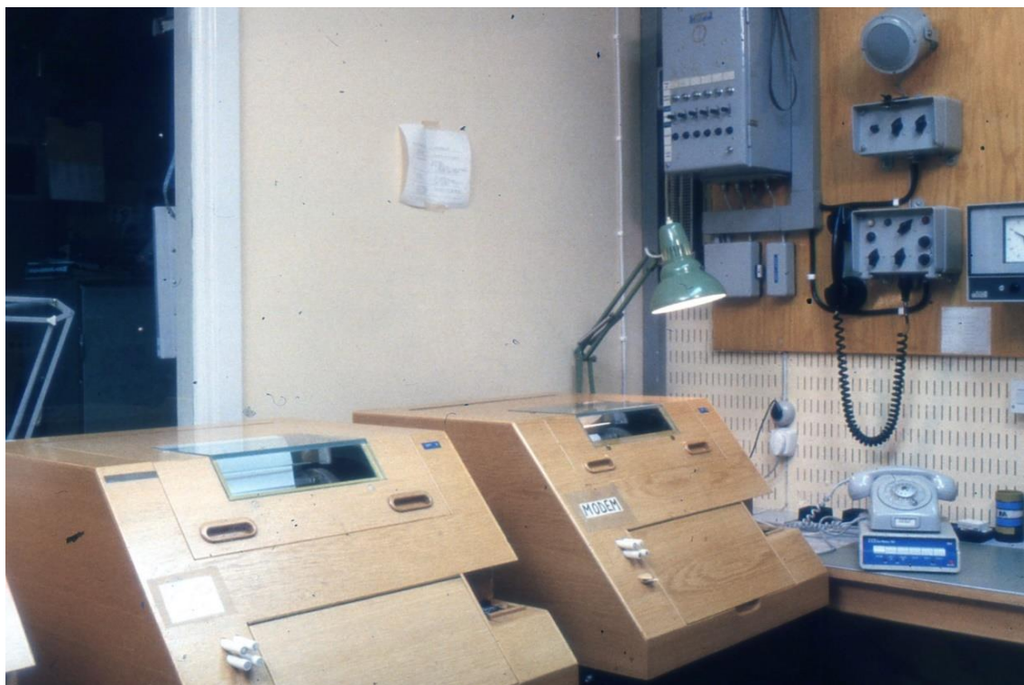
131. Kustradiostation mottagardel. Betjäningsplats för fjärrskrift
