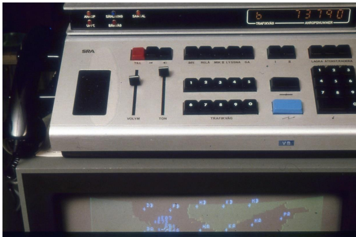
115. Sjöbevakningscentral. Fjärrmanöver för VHF-station
