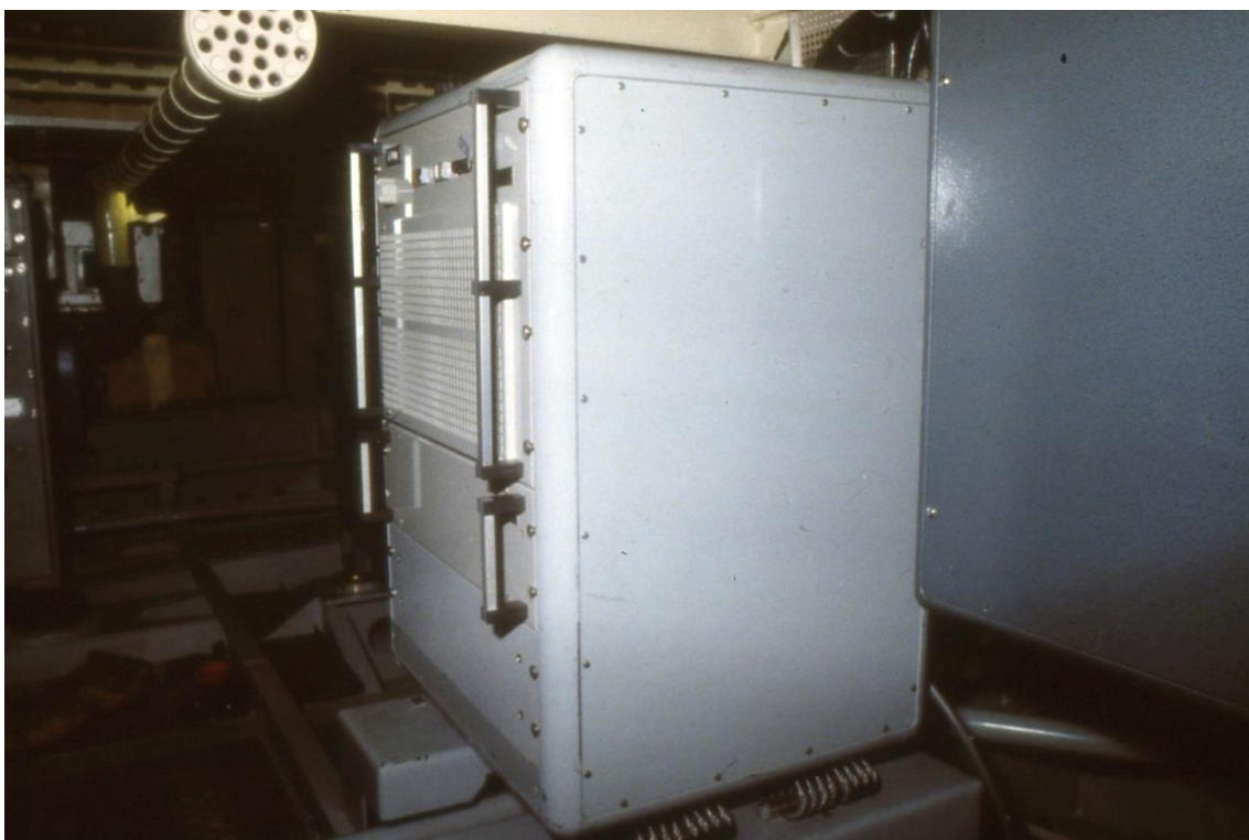
46. Rbb typ Norrköping. SÄ 844 i elapparaturum under stridsledningscentral
