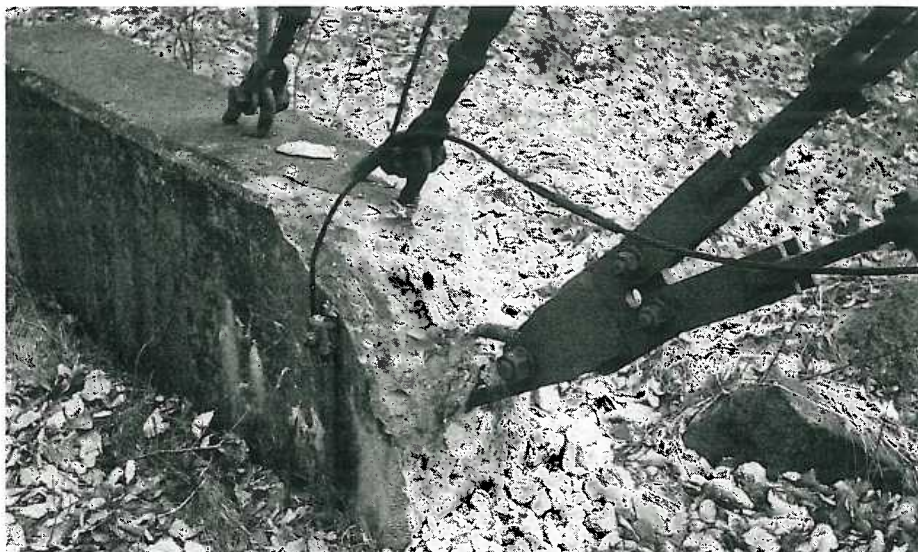
Bild 1. Skada på stagfundament.
