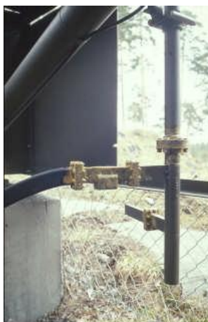
Vertikala cirkulära vågledaren vid mastfoten
