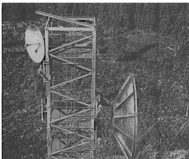
Parabolantenn för scatterlänk monterad i torn
