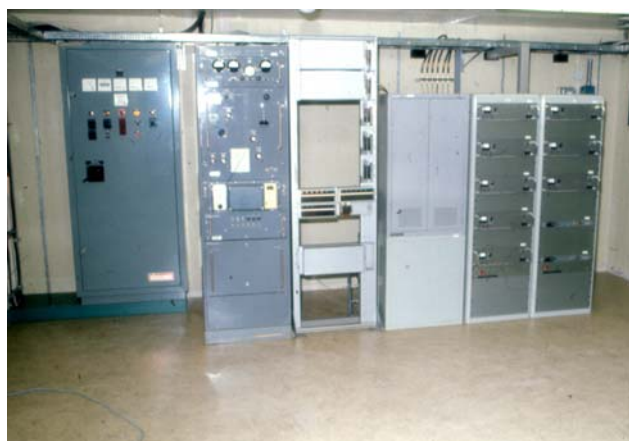
Roslagen Radio, apparatrum med sändare 1,5 kW, tonkanalutrustning och antennförstärkare.
