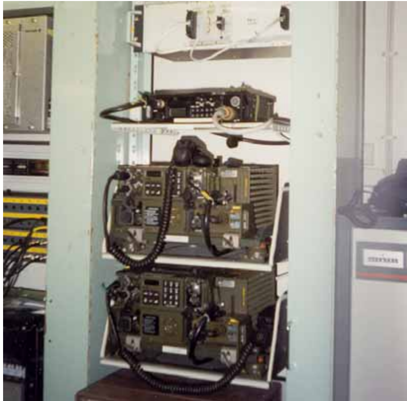
Bild 61. Ra 480 i marin anläggning. På översta hyllan en Ra 81.
