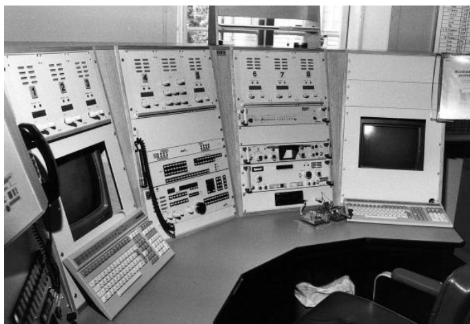
Operatörsplats med utrustning för KV- och LV-trafik; MHS (bildskärmar och tangentbord) Fjärrmanöverutrustningar för sändare och mottagare. Plats för två operatörer.
