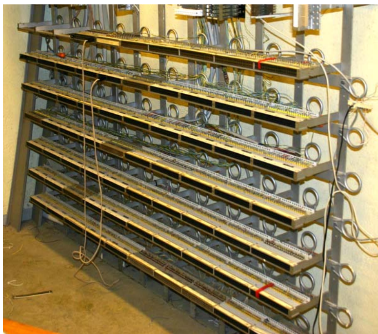
Bild 2. Korskoppling (KK) i större KA-anläggning, här en KAB-stabsplats.
