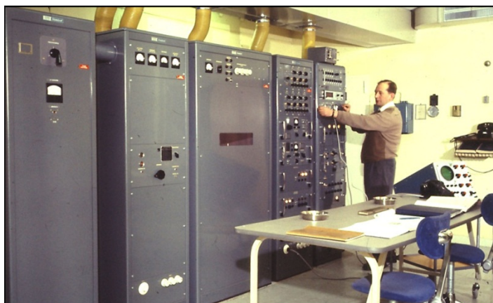
Sändarrummet med Ing Noaksson under utprovning
