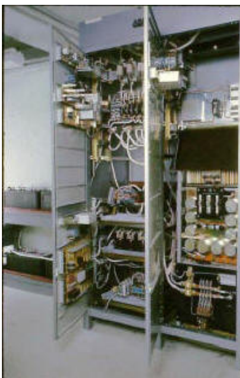
Bild 18. Växelriktare (närmast) och likriktare.
