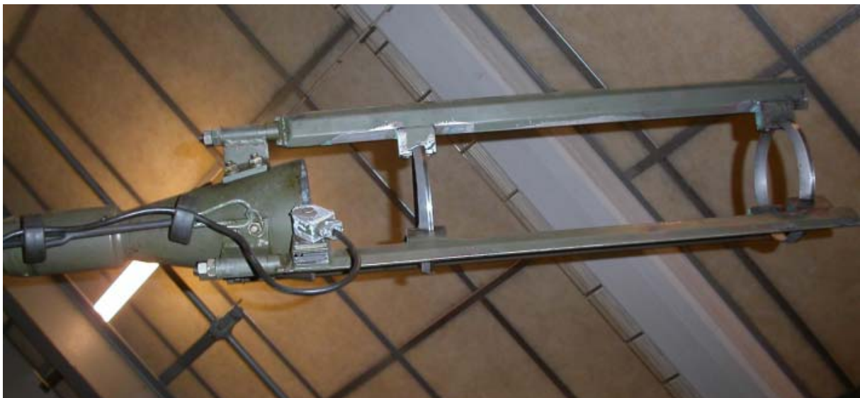
Närbild av monterad Vo mätutrustning på 40 mm lvakan
